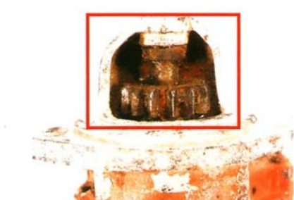
PASTOREK JE SILNĚ ZKORODOVANÝ
